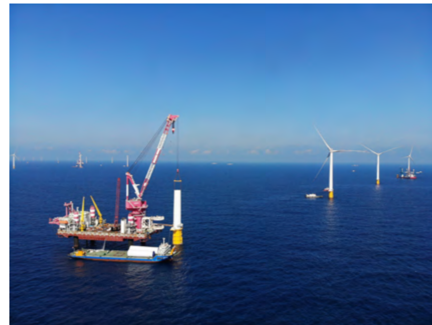
广东揭阳神泉二 350 兆瓦海上风电增容项目
